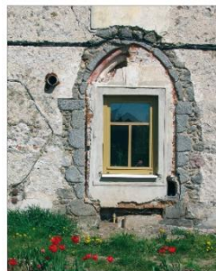
Obr. 2. Částečně odkrytý raný gotický portál.
